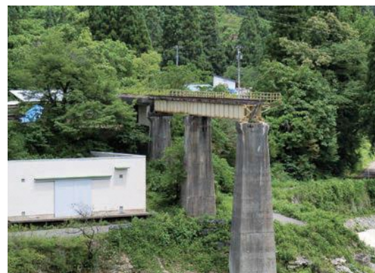
▲流された只見川第6橋りょう（金山町）
